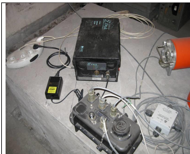
Фиг. 2. Оборудване на станция SGFI (#4515)
